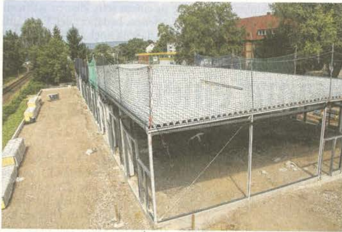
Hier finden Sportwagen, Oldtimer und Boote bald ein neues Zuhause: Rohbau der Garagenanlage der Firma Logemann am Südring.
