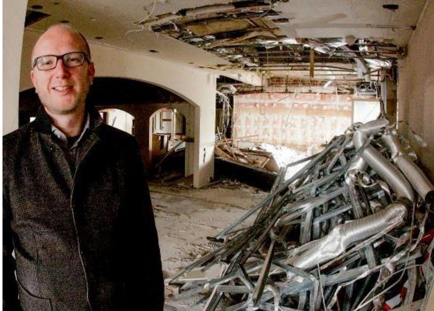
Entkernt: Die Gaststube des ehemaligen Lokals Felsenkeller sieht derzeit aus wie eine Sammelstelle für Altmetall. Architekt Henning Bökamp rechnet damit, dass Mitte nächster Woche der Bagger anrücken kann, um das Gebäude abzureißen.
