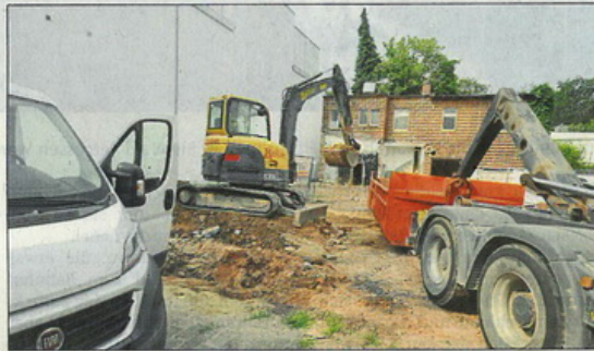
Das Abbruchunternehmen Rolker hat mit vorbereitenden Arbeiten für den Neubau an der Klosterstraße begonnen. Foto: Claus Brand
