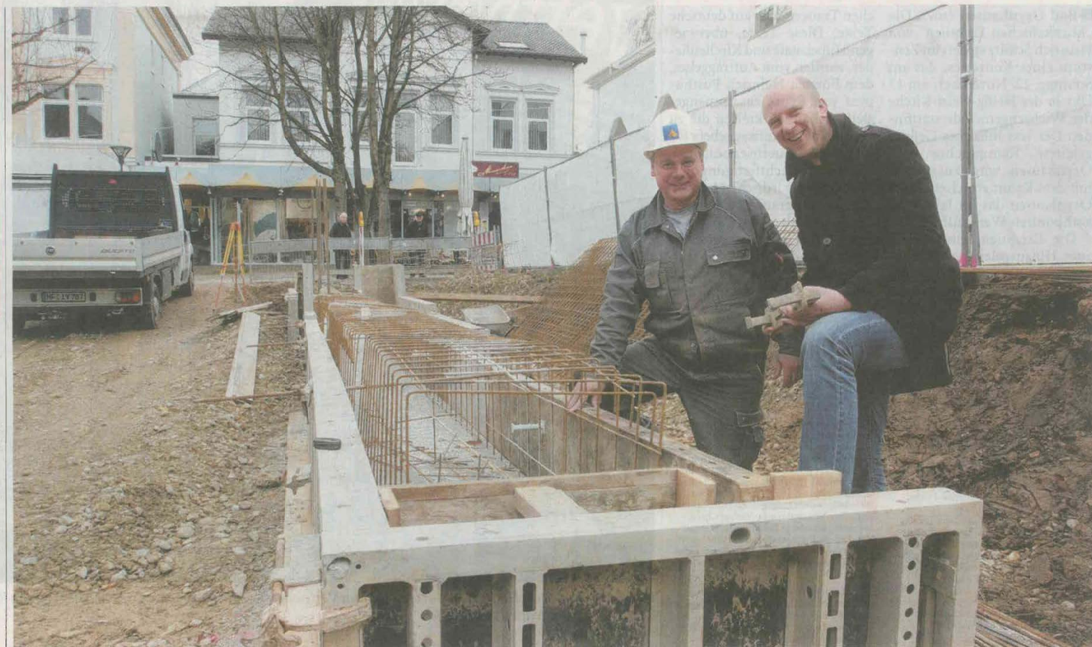
Vorfreude: Architekt Henning Bökamp und Bauarbeiter Detlef Leonhardt schauen sich eines der ersten Fundamente an. Mehr als zwei Jahre nach dem Abriss der „Rosenstuben“ entsteht mit einem Wohn- und Geschäftshaus neues Leben an der oberen Klosterstraße.
